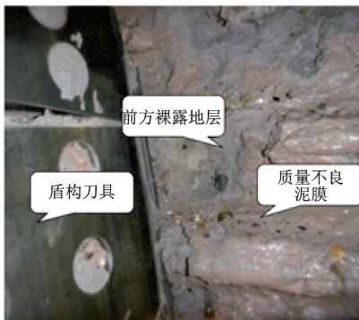
图13 南京纬三路过江隧道开挖面不良泥膜 [15]
